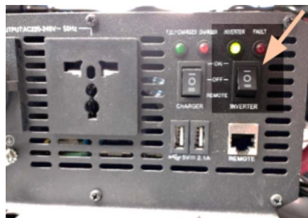
Figuur 4: omvormer ingeschakeld
