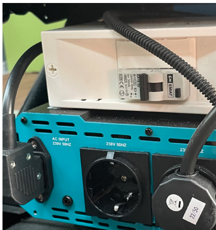
Figuur 4: 230v zekering uitgeschakeld
